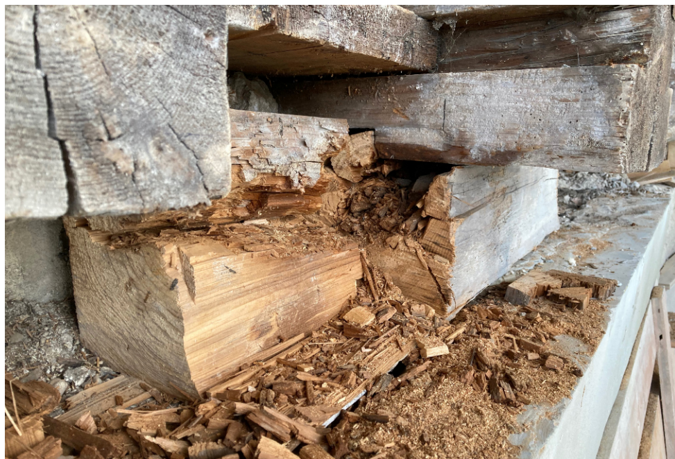
Zustand der Dachschwelle vor der Intervention.
